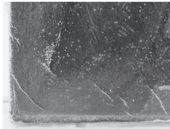
図15. 左下角付近の亀裂、剥落と額擦れ
