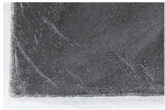
図4.8. 左下角付近の亀裂、剥落と額擦れ
