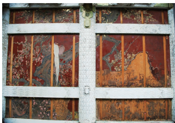
図1. 東側壁面全体図（修理前）
