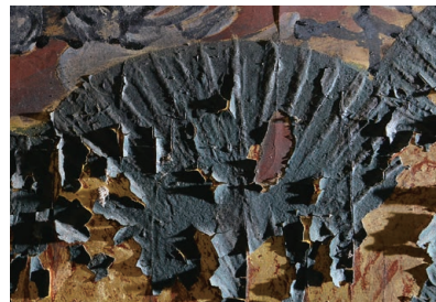
図10. 松葉部分（修理前）
