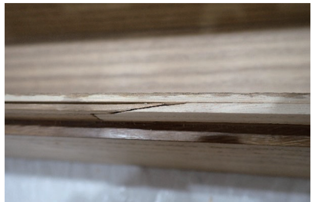
図92. 矧ぎつけ部隙間
