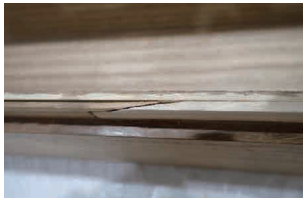
図92. 矧ぎつけ部隙間
