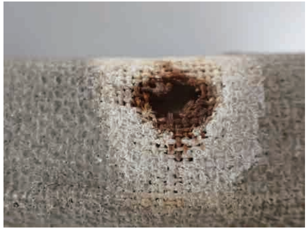
図10. 釘の錆による腐食
