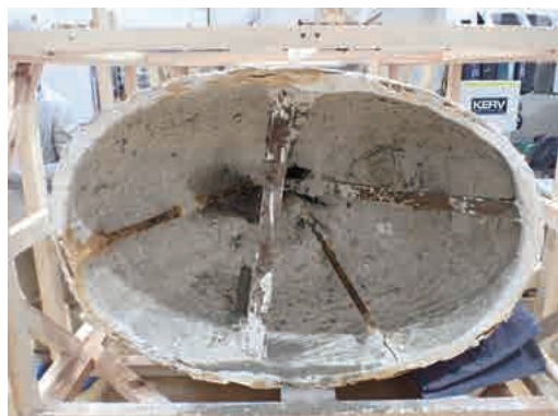
図6 丸棒と番線の錆と損傷（像底）
