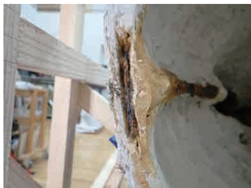
図8 番線の錆による欠損（周縁部）
