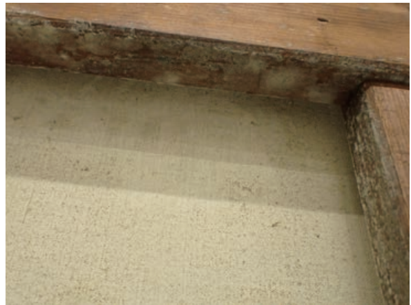
図16. 木枠裏面に生じたカビ
